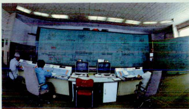
地区电力调度——新乡供电局调度室
