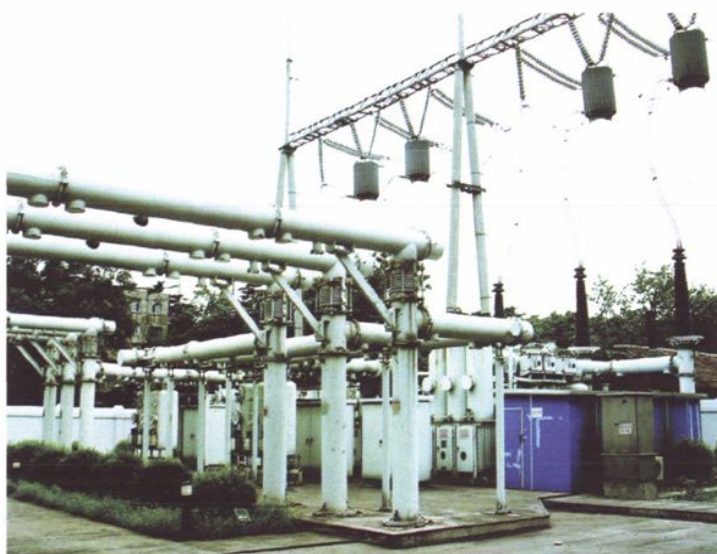
江苏院 1999 年 7 月完成设计的 220 千伏南京中央门变电所工程 (省内首次采用 220 千伏 GIS 设备), 2002 年获江苏省第十届优秀工程设计一等奖
