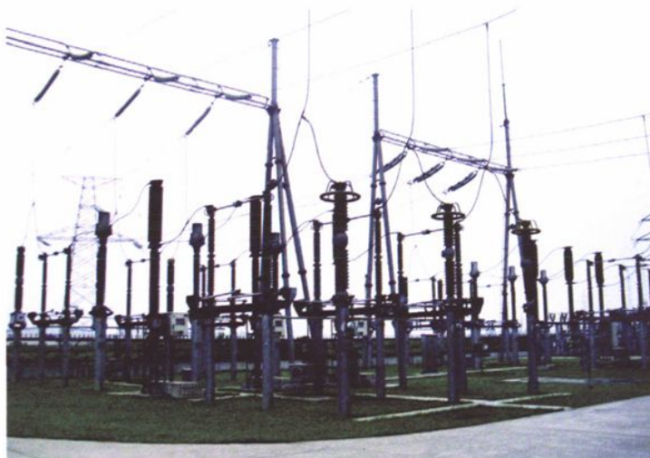
江苏院 2001 年 9 月完成设计的 220 千伏震泽 (慈云) 变电所是省内第一个按无人值班、远方微机监控设计的 220 千伏变电所
