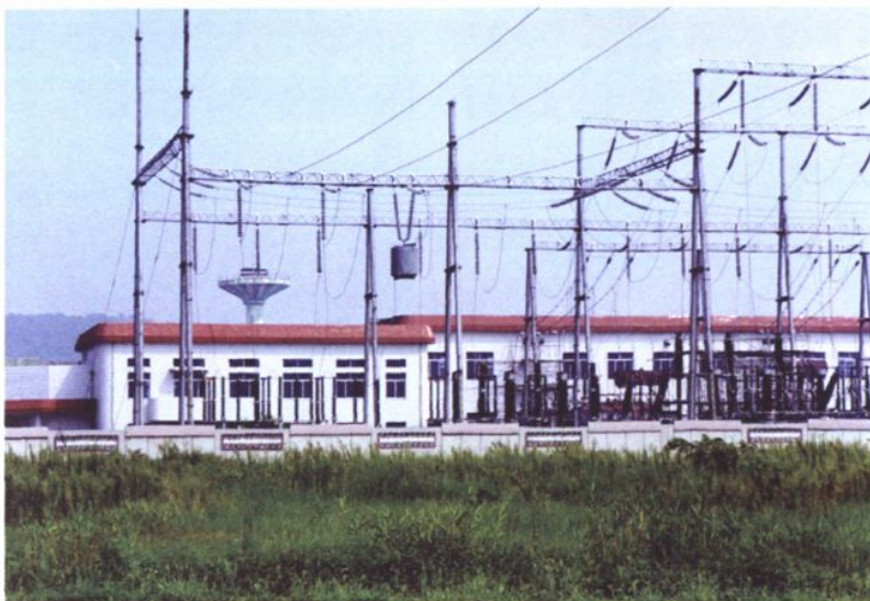
由江苏院、省电力实业总公司、江阴供电局联合承包建成的220千伏江阴沿山钢厂变电所(2001年8月)
