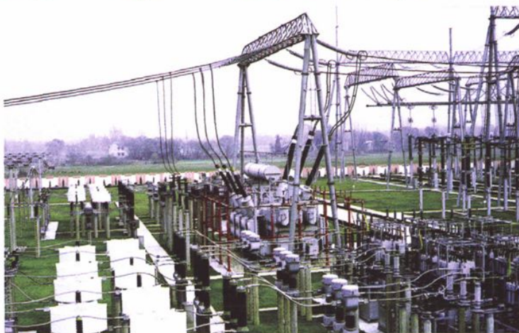
江苏院 1999 年 7 月完成 设计的 500 千伏上河（淮阴） 变电所工程，2003 年获第十 届全国优秀工程设计银奖
