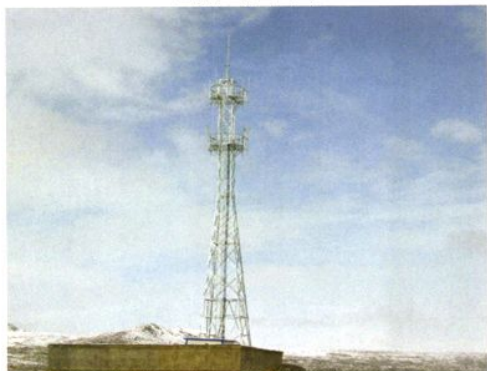
移动通信基站
