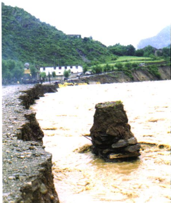
“7·11”特大洪灾多处公路路基毁坏
