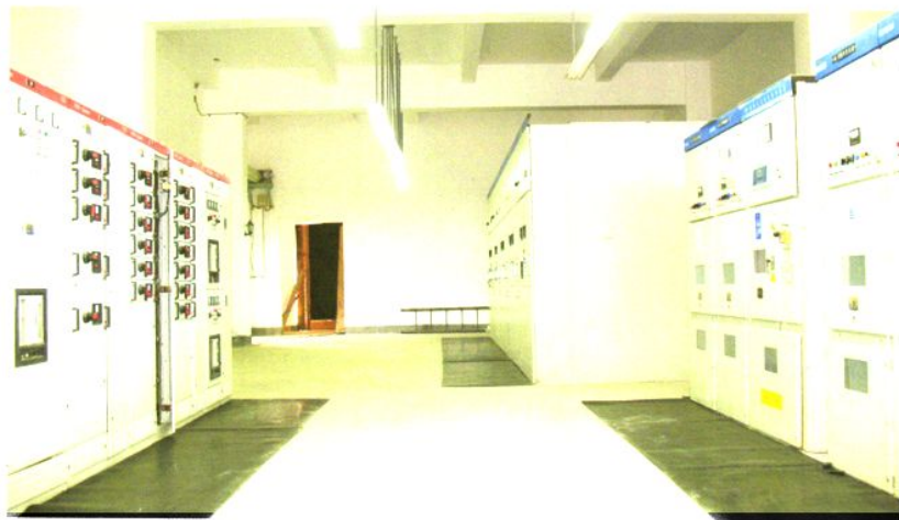
瓦其拉水电站中央控制室
