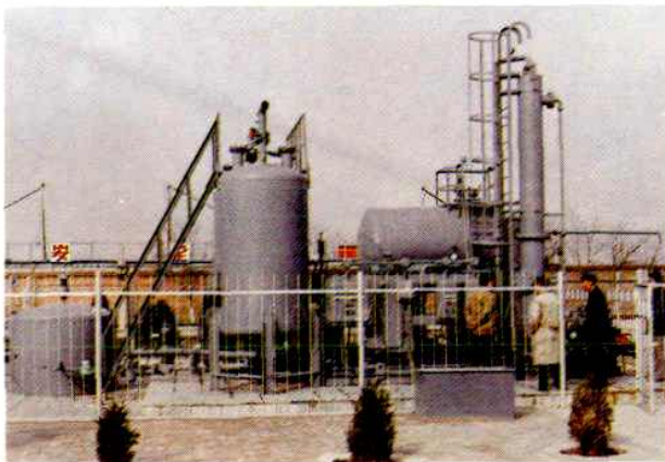
油气回收设施
