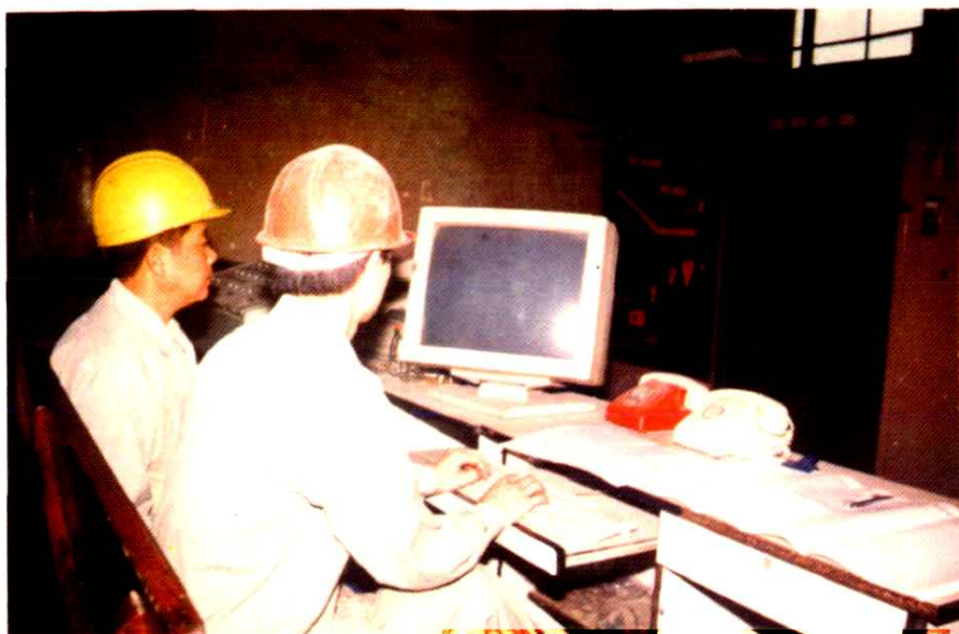
水泥厂中心控制室
