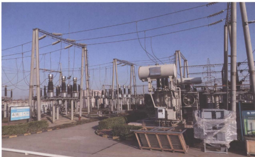
六村 110 千 伏输变电站
