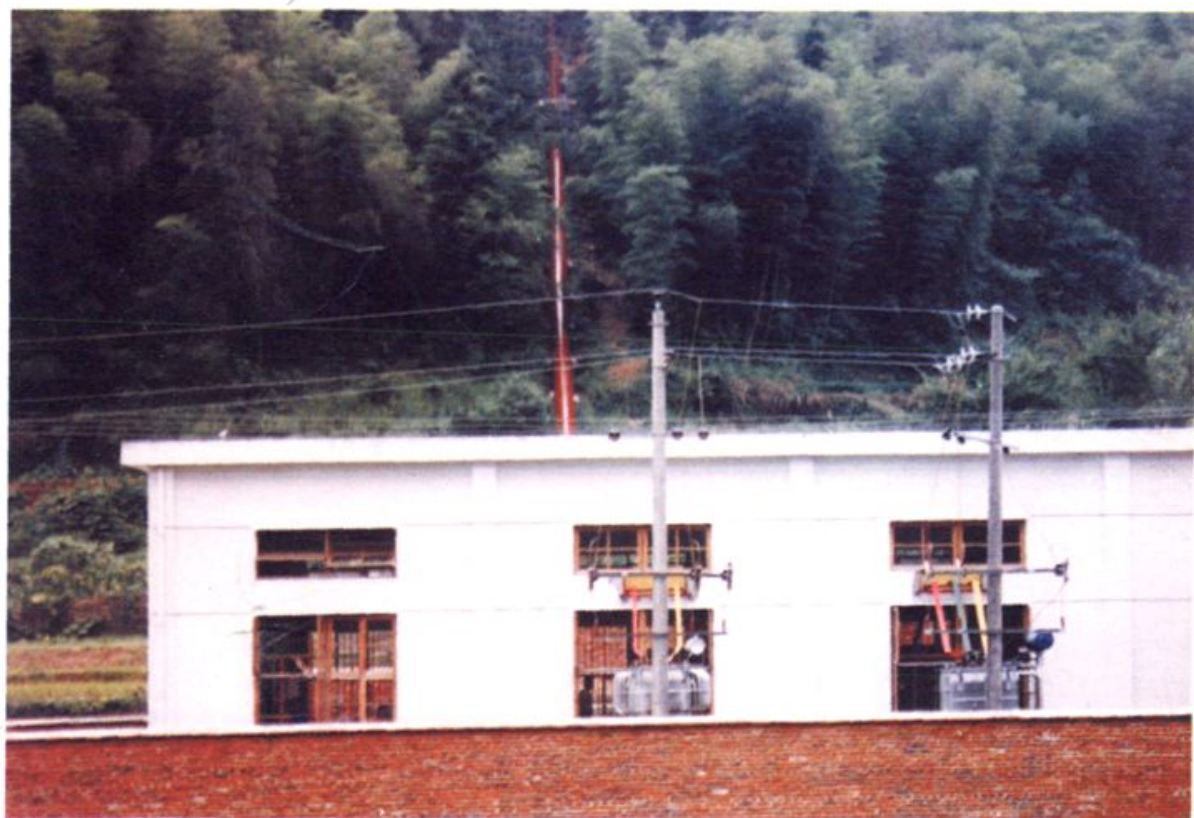
▲ 株洲市农村信用社大力支持开发山区资源的各项建设。图为炎陵县凌云信用社支持的谢建华电站机房
