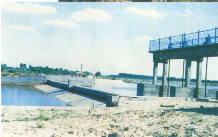
大兴胜利渠首橡胶坝
