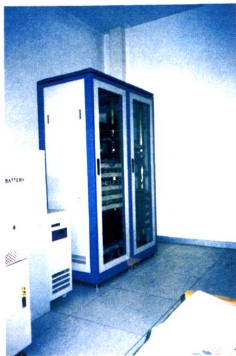
金财网络工程主机房
