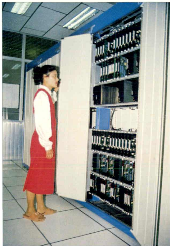
▶ 县邮电局程控电话机房
