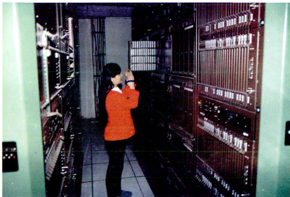
▲程控交换机房
