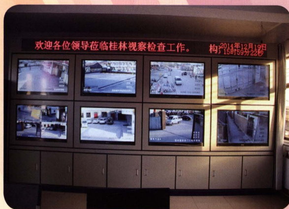
镇视频监控平台
