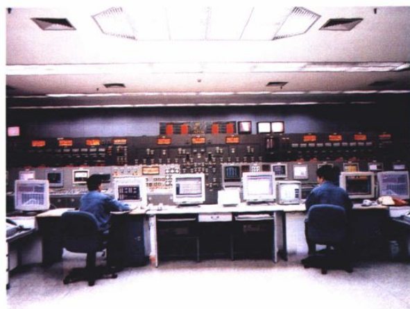
● 邹县电厂60万千瓦机组集控室
