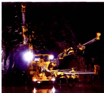
▲ 液压隧道凿岩台车
