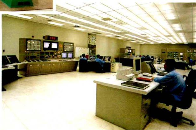
▶ 3、4号机组集控室
