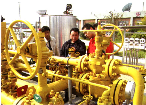
西气东输防雷安全检查
