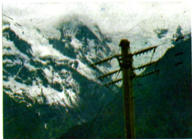
县发电厂35千伏输电线路
