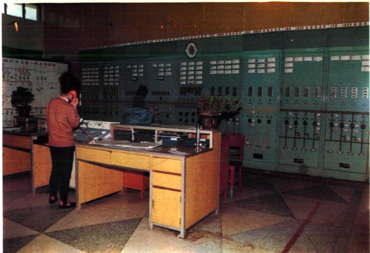
三毛山变电站控制室
