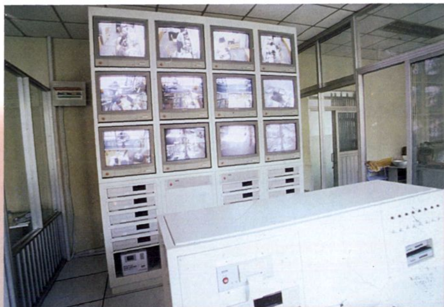
1998年8月,建成电视监控报警系统。照片为县局总监室
