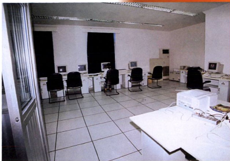
1997年8月,建立电信网管中心,电信管理网将为电信网提供一系列管理功能,通过实时掌握全网情况,自动处理各类故障,保证电信网络运行正常。照片为县局电信网管中心机房。
