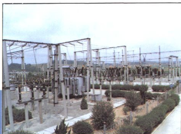
西郊 110 千伏变电站
