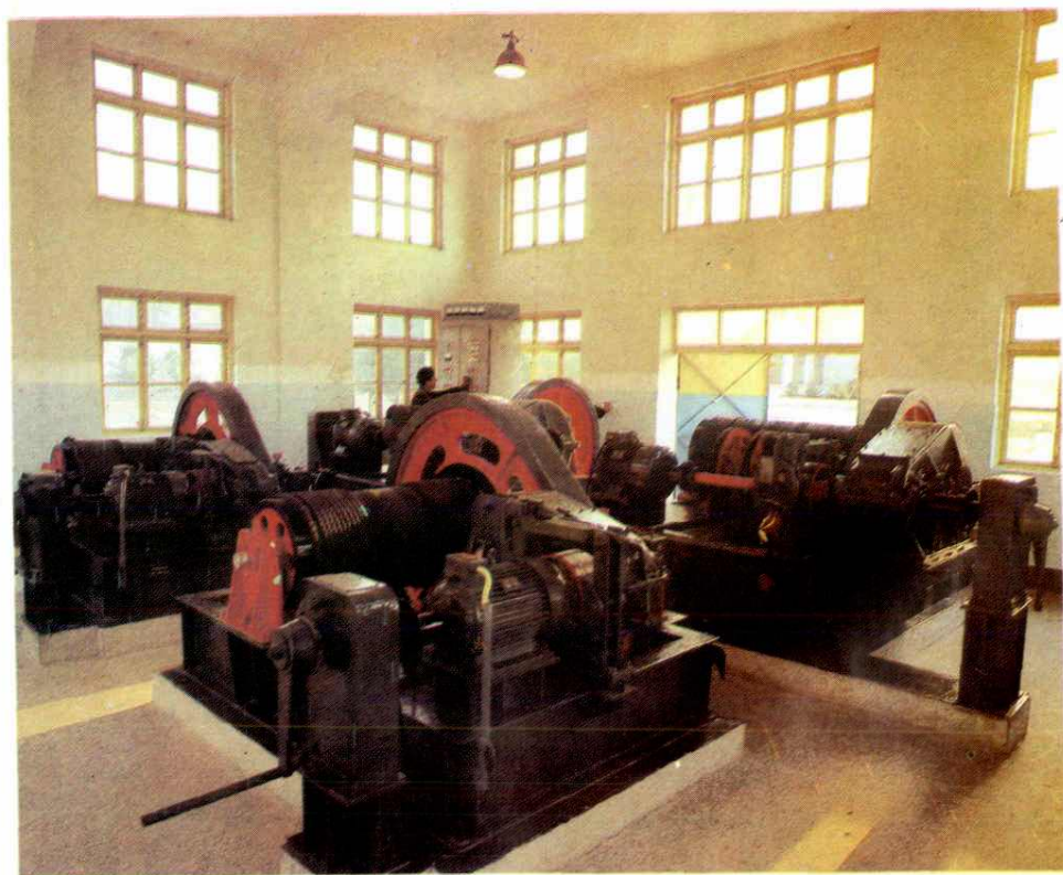
输水洞启闭机室
