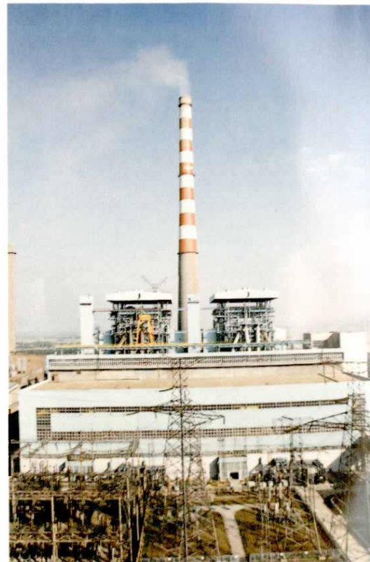
华能电厂主厂房
