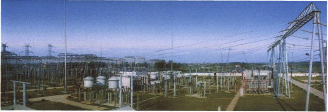
华东电网第一个500千伏输变电达标投产工程 ——浙江金华变电站
