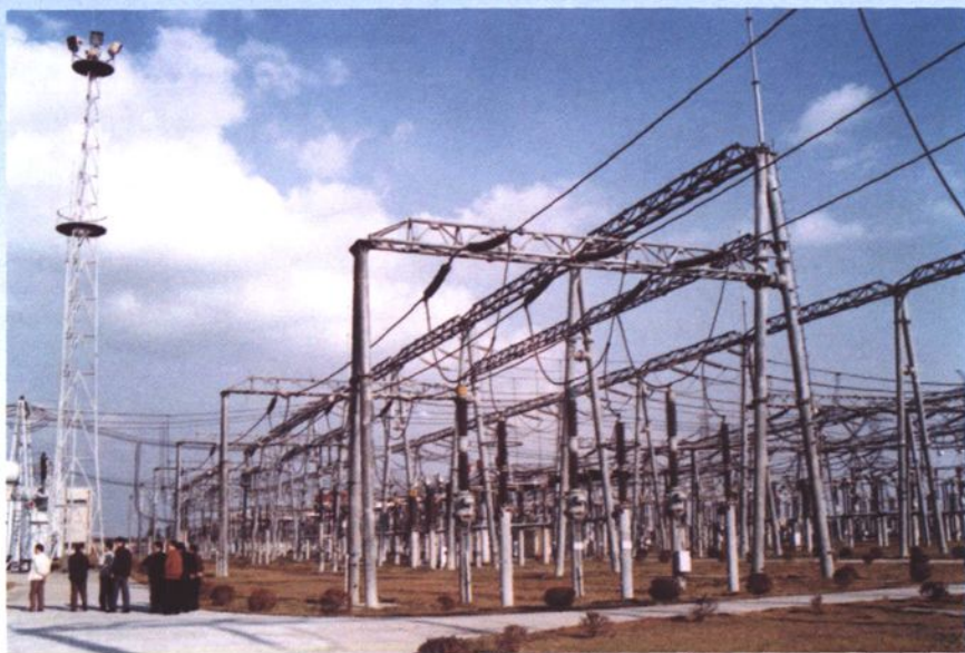
1991年，上海 500千伏南桥交直流 变电站扩建工程建成 投运
