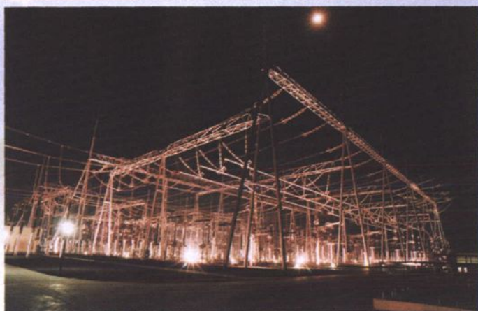
2002年10 月开工建设的 江苏500千伏 锡东南变电站
