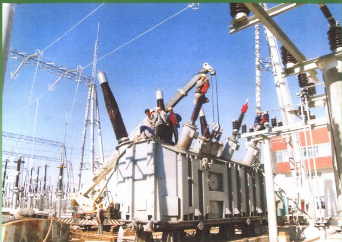
2001年对变压器进行检修
