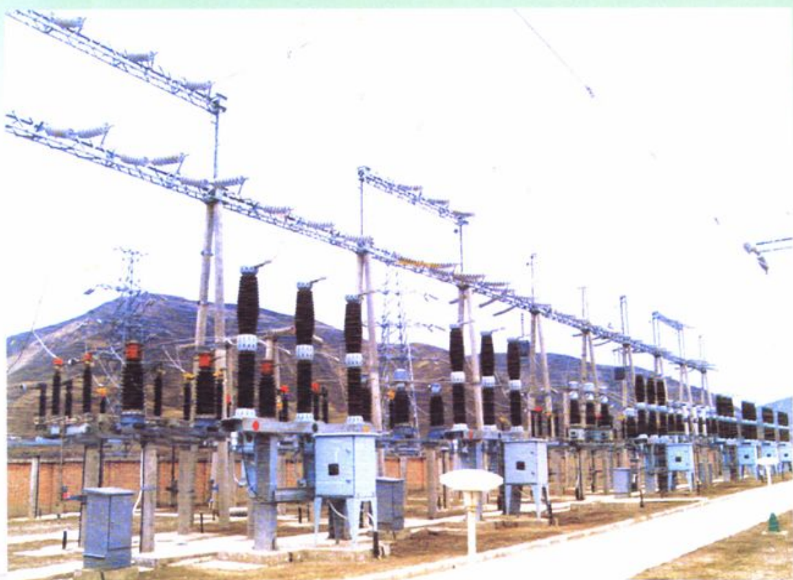
1998年以来，通过加快电网建设，一座座新建变电站相继投入运作
