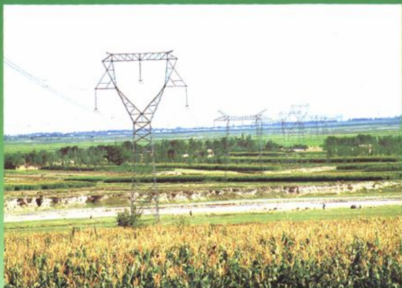
1995年新投用的330千伏输电线路
