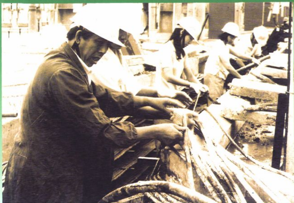
1997年机关干部职工对330变电站电缆沟进行清理
