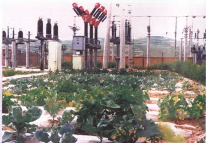
1999年新改造的330千伏变电站
