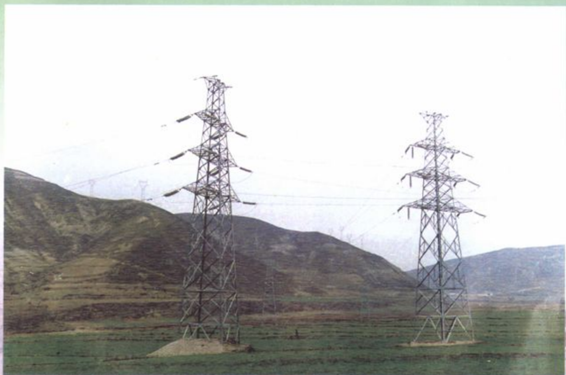
2002年以前，经过多年建设，一排排整齐的线路把光明送到了千家万户
