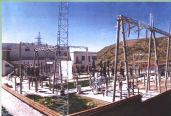
2001年新投用的110千伏变电站
