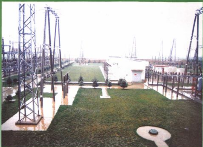
1994年新投用的330千伏变电站
