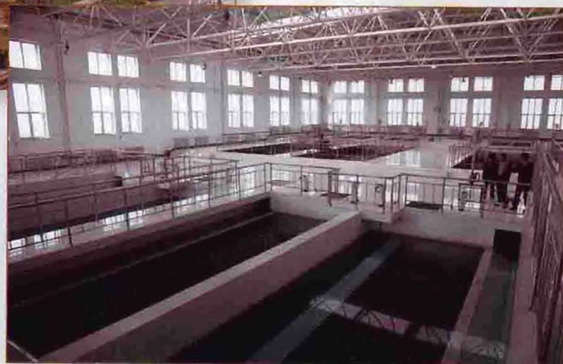
唐山市曹妃甸工业区供水有限 责任公司水处理设施
