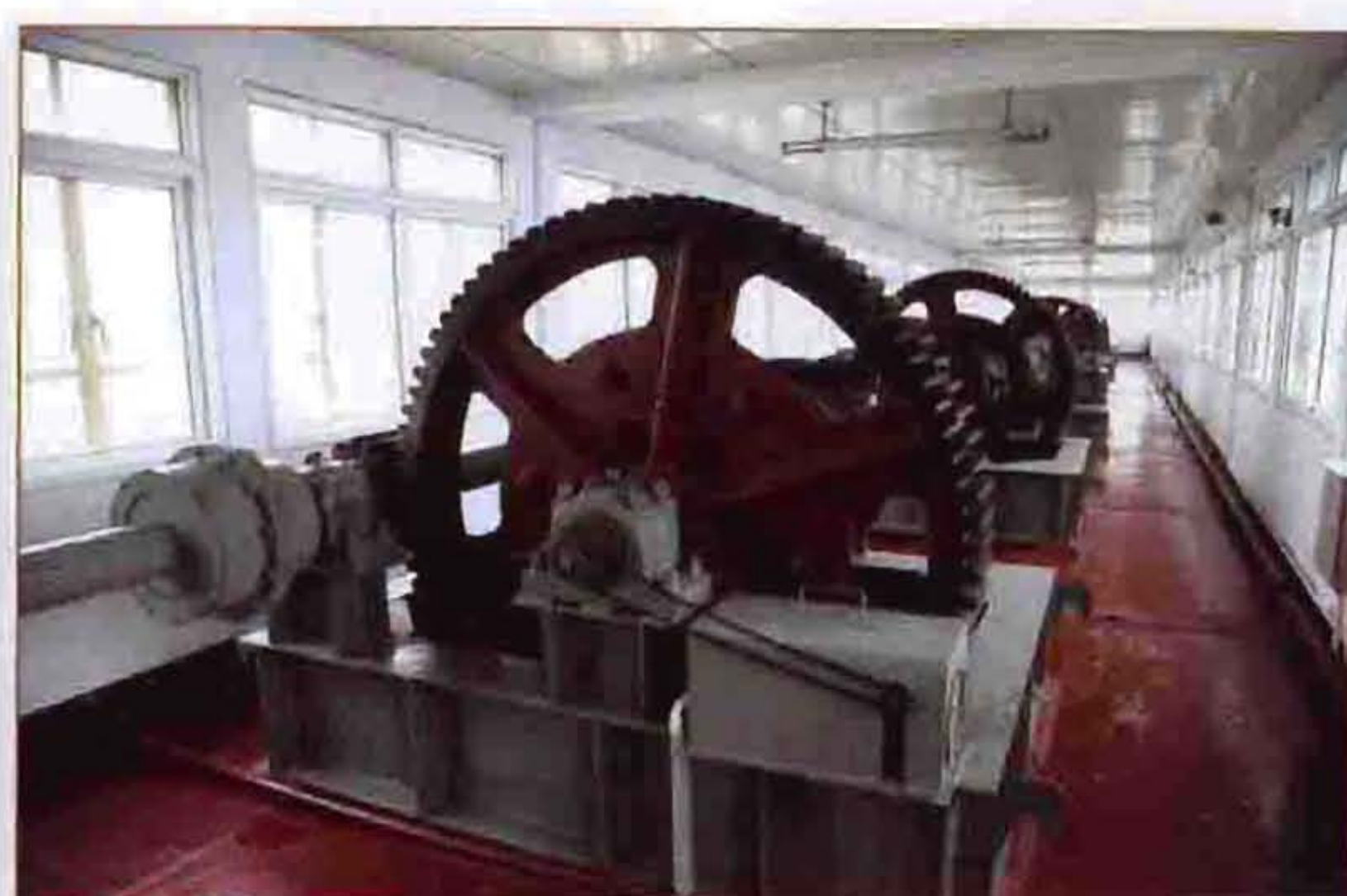
邱庄水库机房
