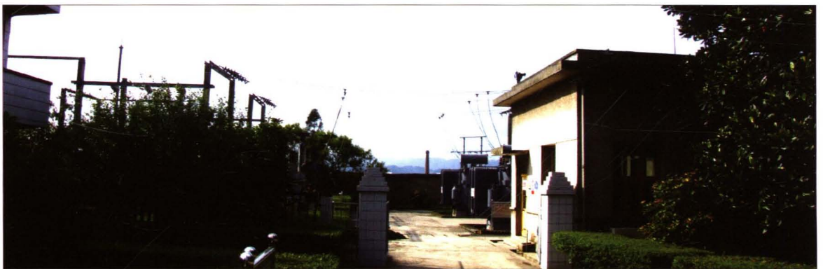
建于1989年12月14日的35千伏和平变电站
