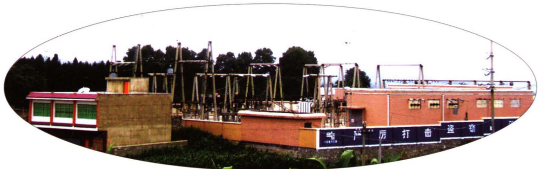
始建于2000年的110千伏扎佐喻街变电站
