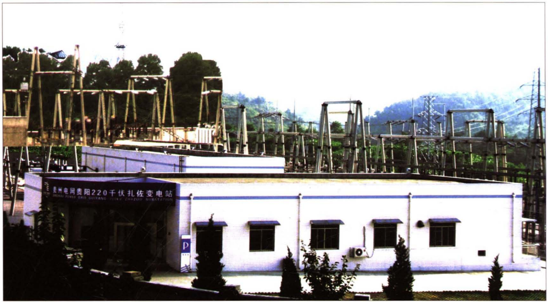
始建于2004年的扎佐220千伏变电站
