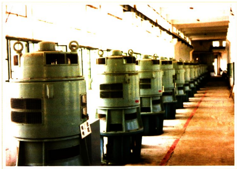
姚塘子扬水站泵站一侧
