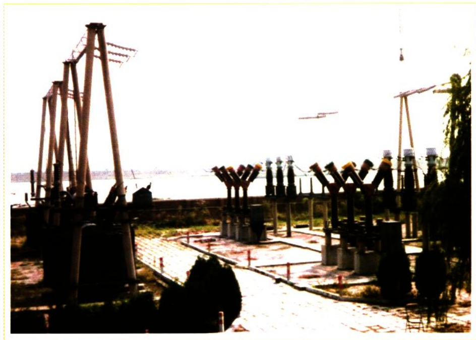
姚塘子扬水站专用110千伏变电站
