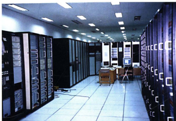
电力系统仿真试验室
