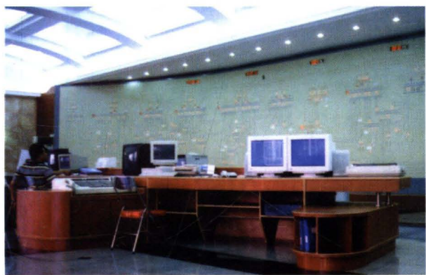
电科院与东北电管局联合开发的CC-2000开放式、面向 对象 EMS/DMS 支撑系统在大连电网调度中心运行
