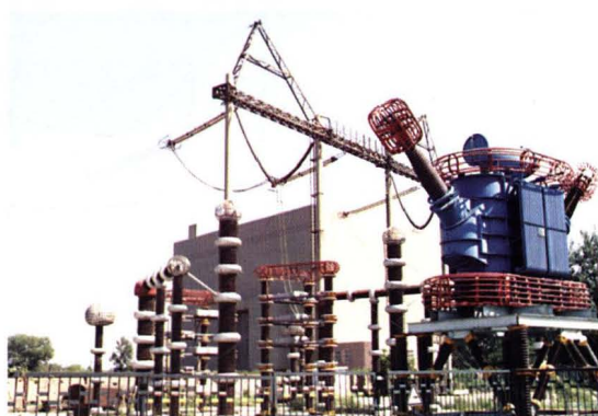
户外 \pm 1000 千伏75毫安直流电压发生器
