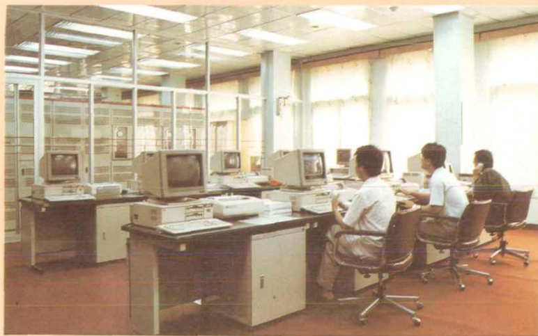
程控机房控制室 (1990 年 8 月摄)
