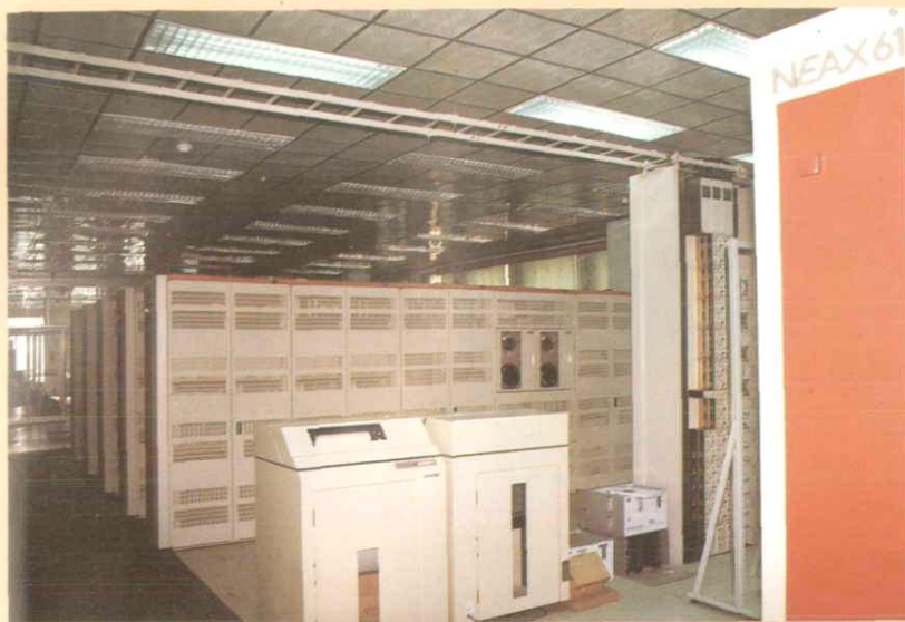
NEAX61 型 22 500门 程控市内电话交换机 设备 (1990年8月摄)
