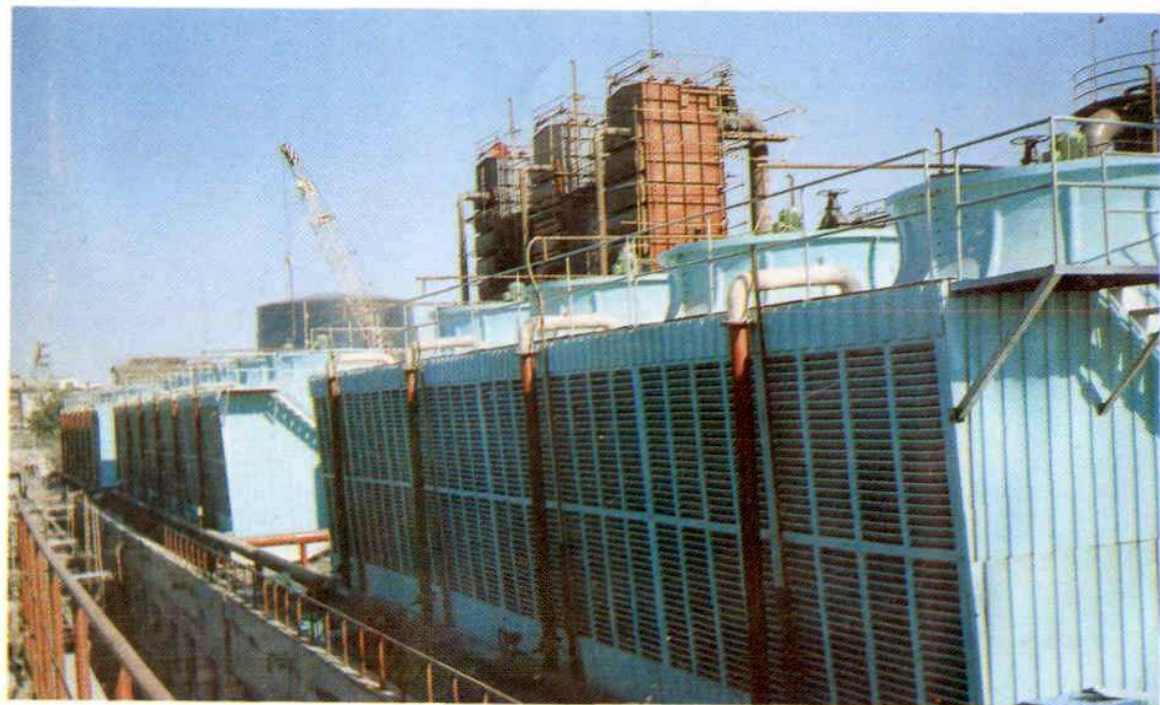
玻璃钢冷却塔
