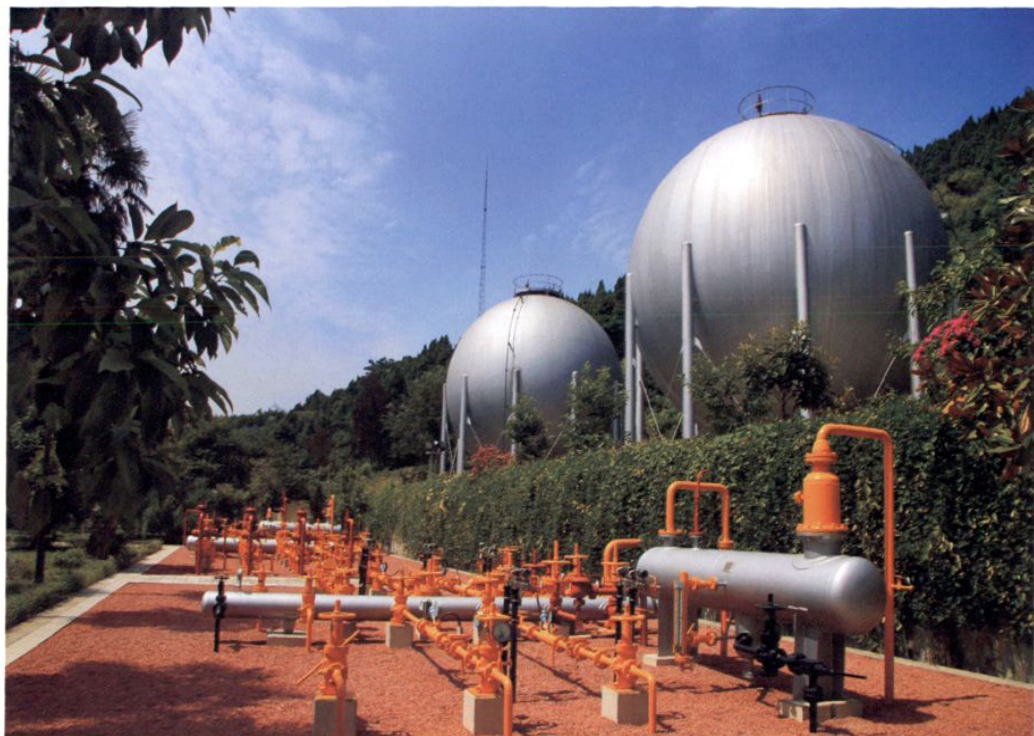
天然气储配站
