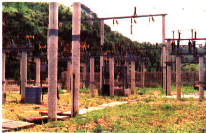
安龙县筏子电站变电工程
