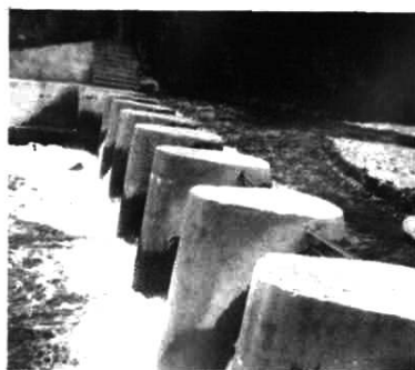
大郎足沟泥石流治理第一坝
