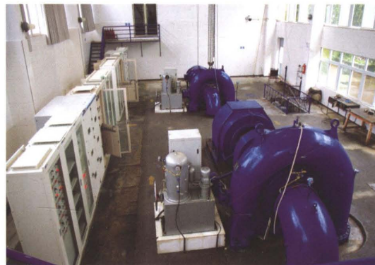
龙潭二级电站机房
