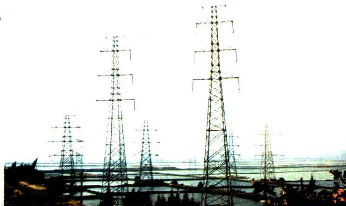
湛江发电厂出线铁塔群
