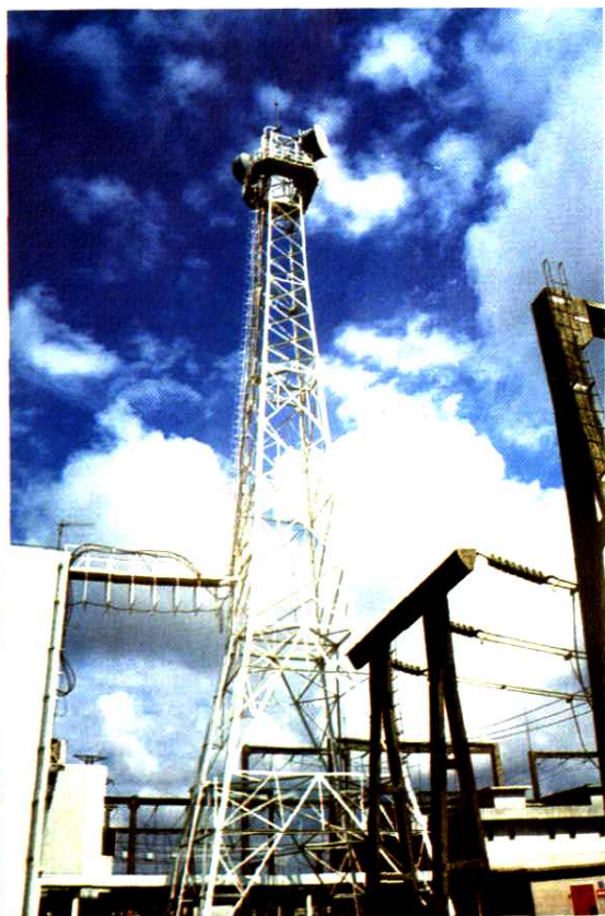
220千伏霞山变电站微波塔
