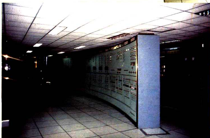
电力培训中心仿真系统室
