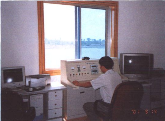
双沟水文站全自动测流装置
