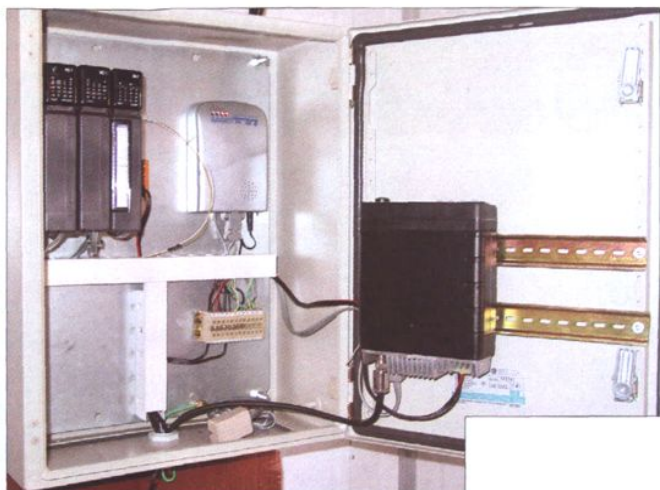
新沂河小潮河闸水位站 遥测装置
