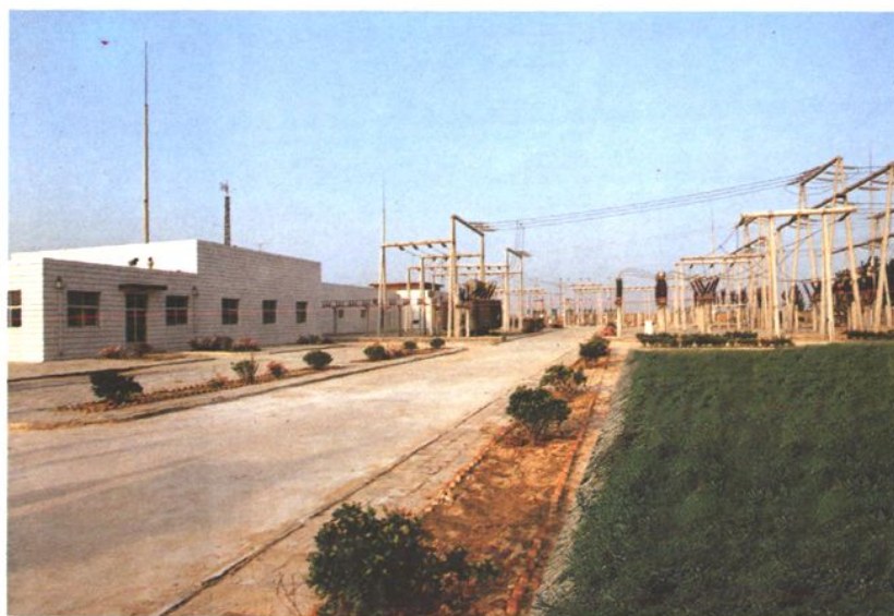
商铺110KV变电站全貌
