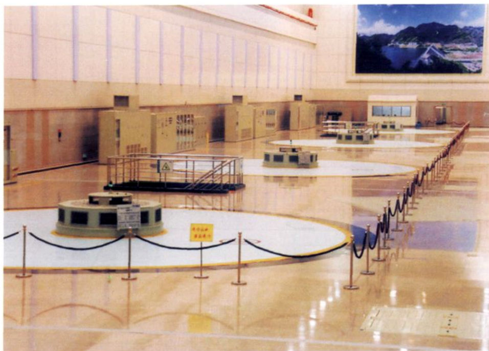
华东桐柏抽水蓄能电站 30 万千瓦 \times 4 台机组车间
