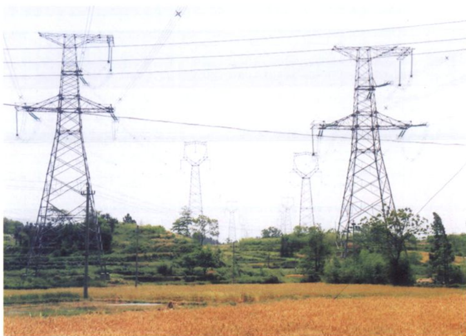
500 千伏桐凤(仪)铁塔网路
