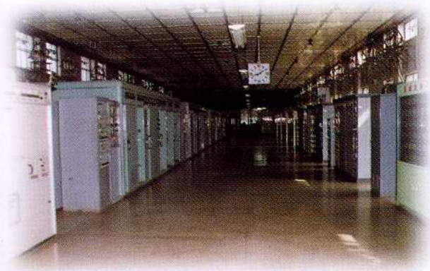
第三通信电台机房
