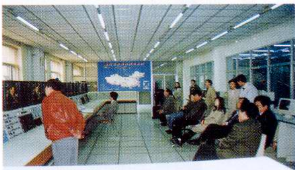
国内卫星通信机房一角
