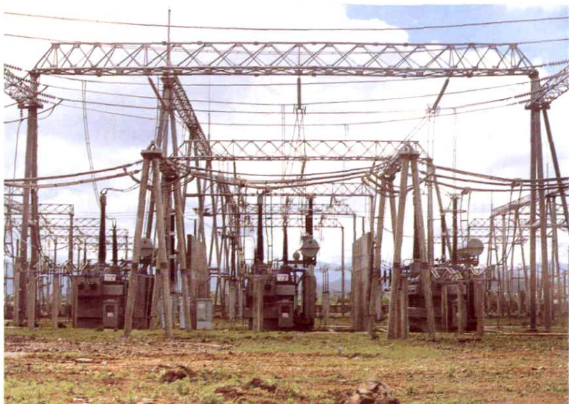
瓶窑变电所 1 号主变压器组 ( 3 \times 16.7 万千伏安)
