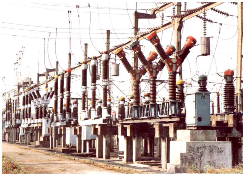
220 千伏杭州变电所一角
