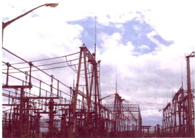
瓶窑变电所 220 千伏母线
