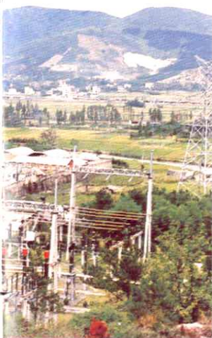
500 千伏瓶窑变电所全景
