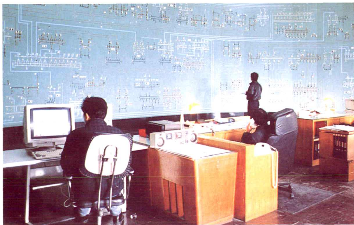
杭州电网电力调度室
