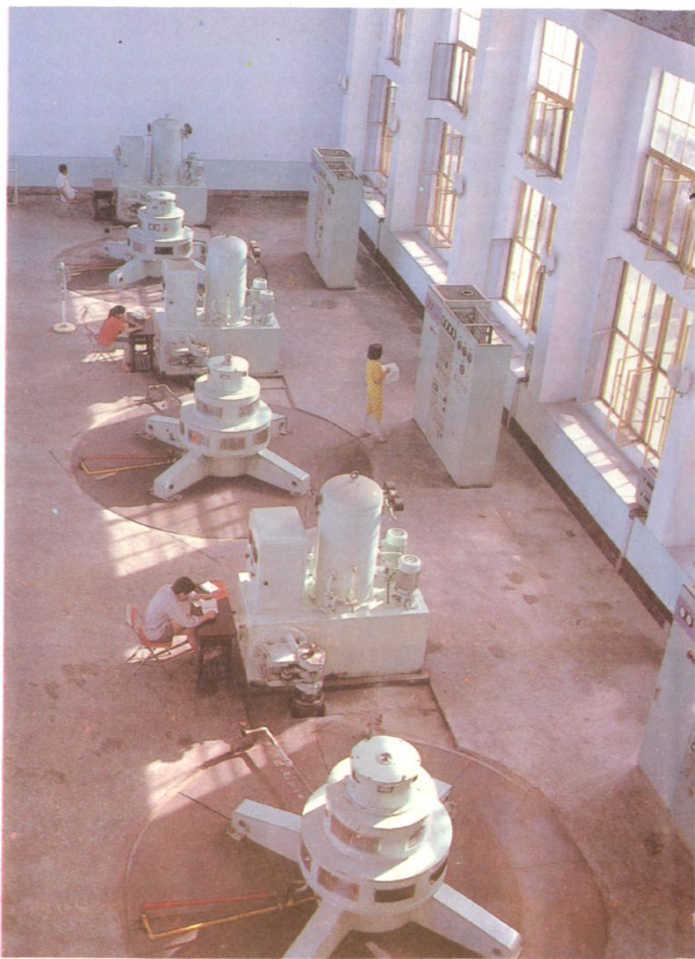
渠首电站内景
