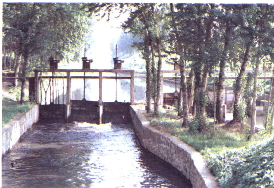
沈抚污水灌区两面闸
