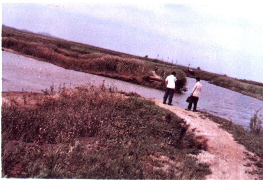
下伯官提水站引水渠水毁现场
