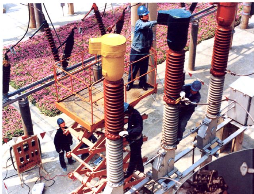
110千伏开关试验现场
