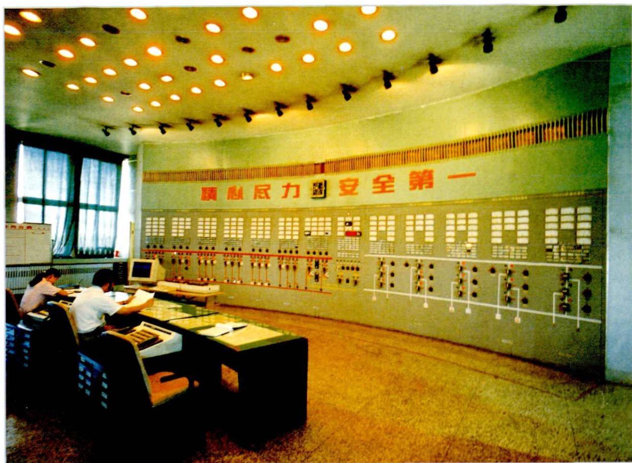
330千伏南郊变电站主控制室
