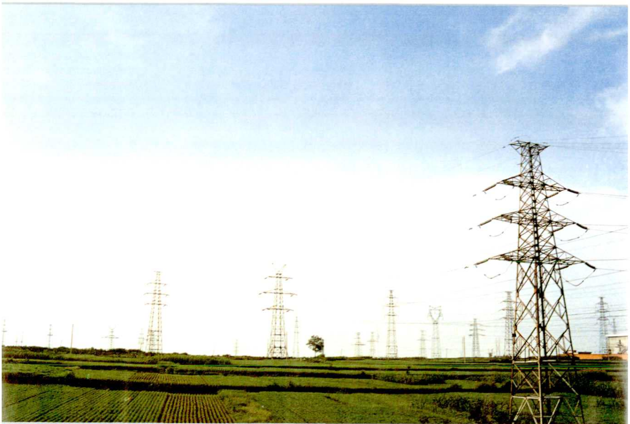
330千伏南郊变电站110千伏出线塔
