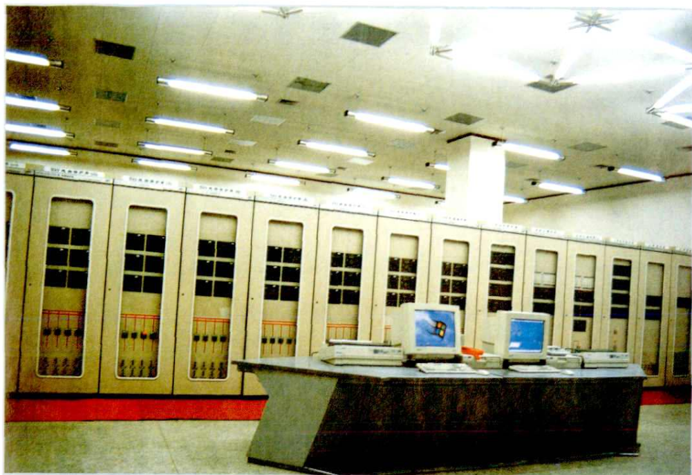
110千伏朝阳 门变电站主控制室
