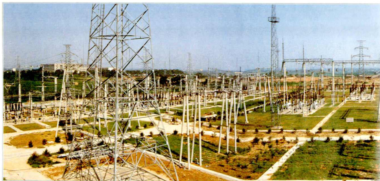
330千伏北郊变电站鸟瞰
