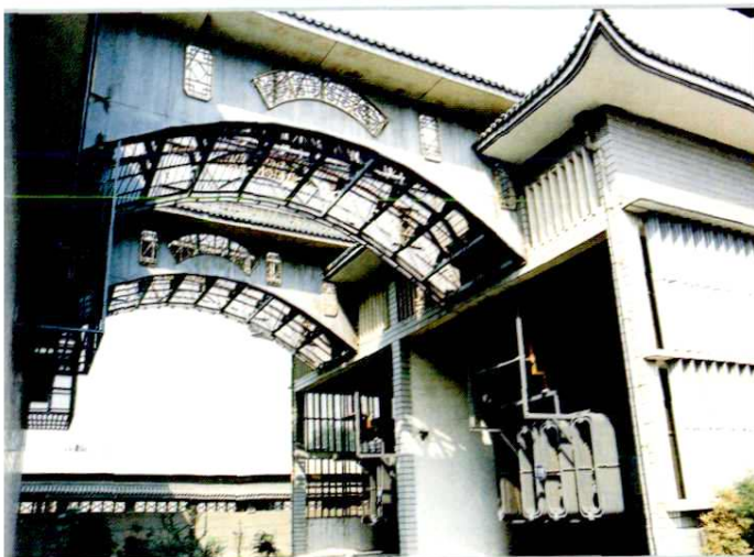
110千伏玉祥门变电站半封闭10千伏母线桥
