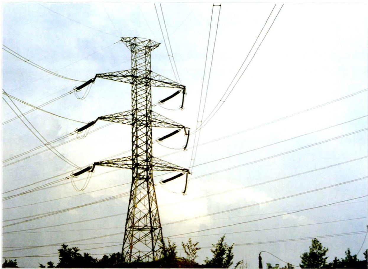
南郊变电站330千伏双回进线塔
