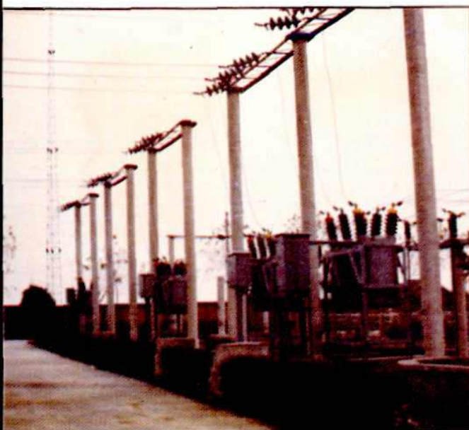
35千伏李小郢标准化变电所
