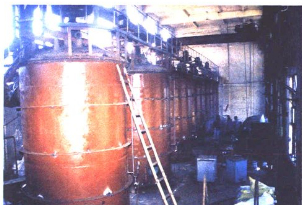
1999 年蒸发技改工程 —— 盐电车间
