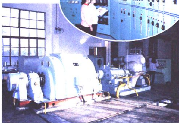
20 吨锅炉配套 1500KW 发电机组
