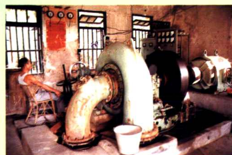
方家口电站机房
