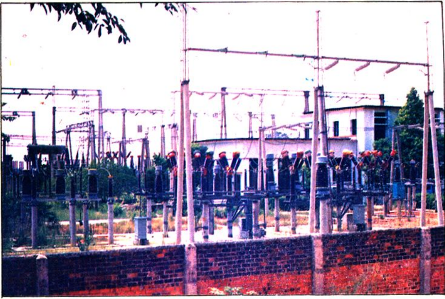
黎塘变电站一角
