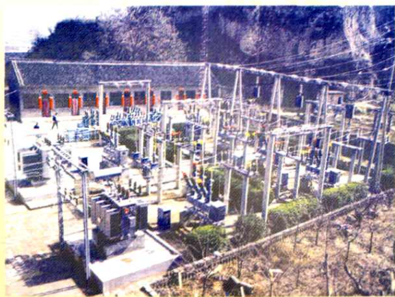
▲ 端氏35千伏变电站
