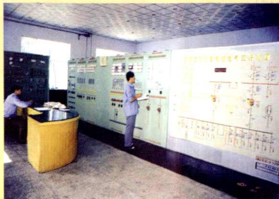
▲ 五柳庄110千伏变电站主控值班室
