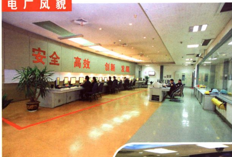
燃气机组集控室
