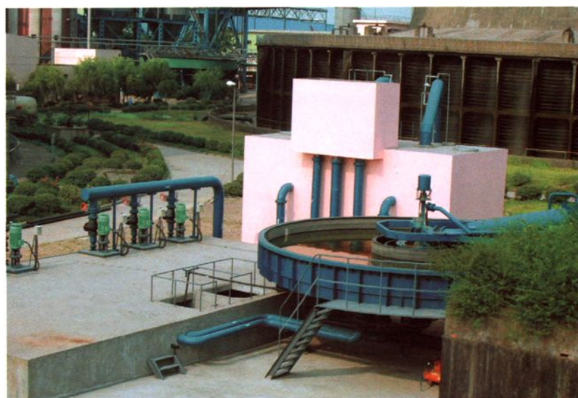
电厂污水处理 设备
