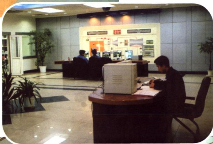
燃煤 4、5 号机 炉集控室
