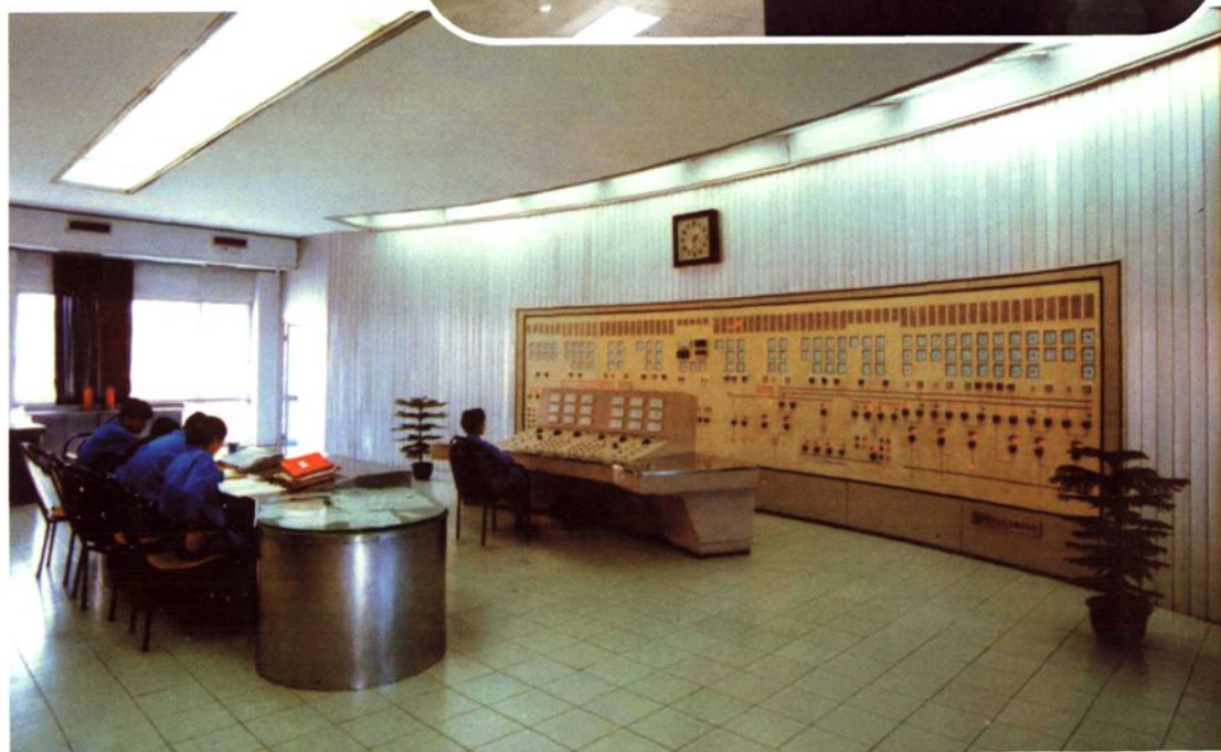
燃煤机组中央控制室
