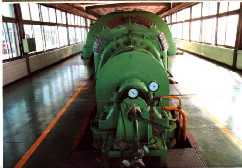
燃煤6号发电机组
