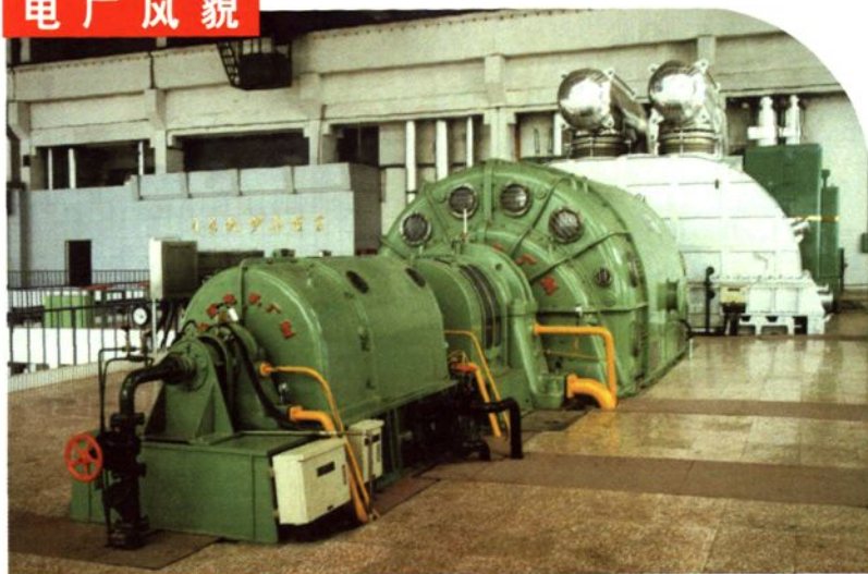
燃煤4号发电机组
